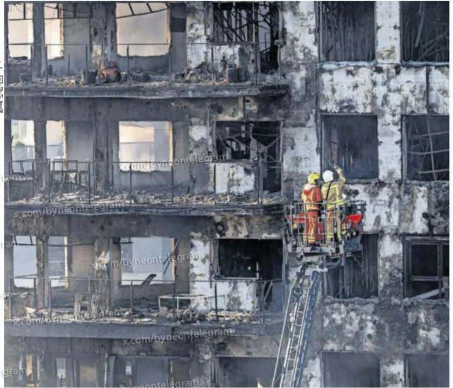
Los bomberos trabajaban ayer en la fachada del inmueble incendiado. MÓNICA TORRES
